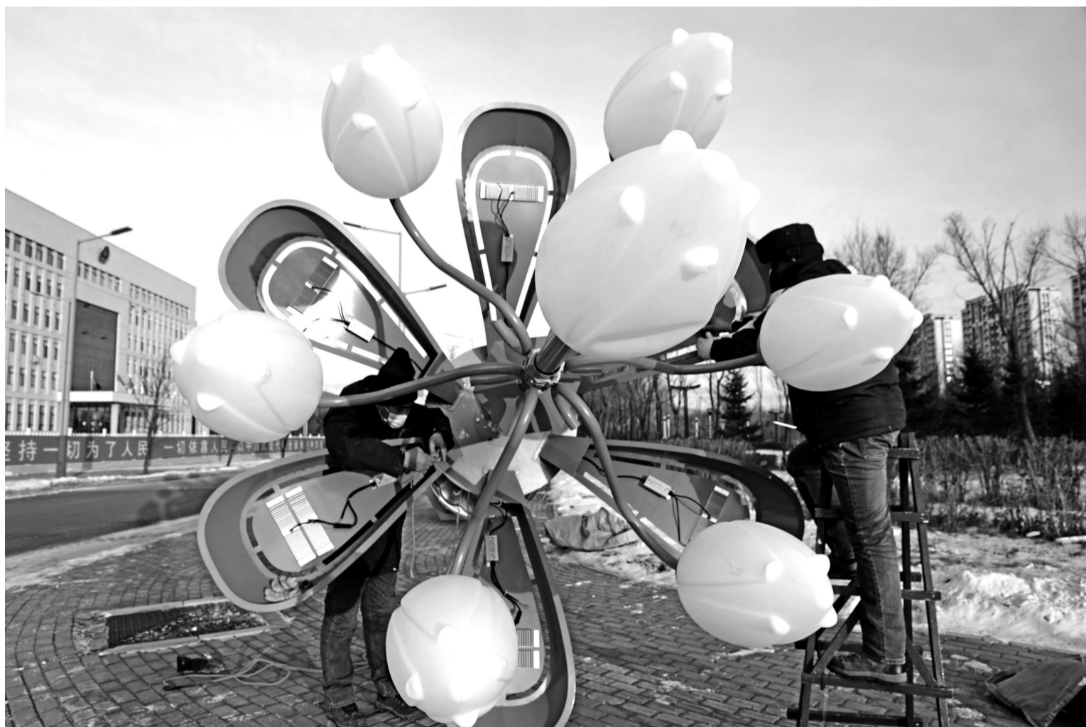
日前,内蒙古自治区呼伦贝尔市扎兰屯市加大亮化工程建设步伐,通过在新建街路安装路灯,在公园广场悬挂多彩LED灯带和满天星灯饰等,把城市装饰得喜气洋洋、年味浓浓。图为12月26日,施工人员在扎兰屯市河西街道振兴路安装路灯。 韩冷 摄
