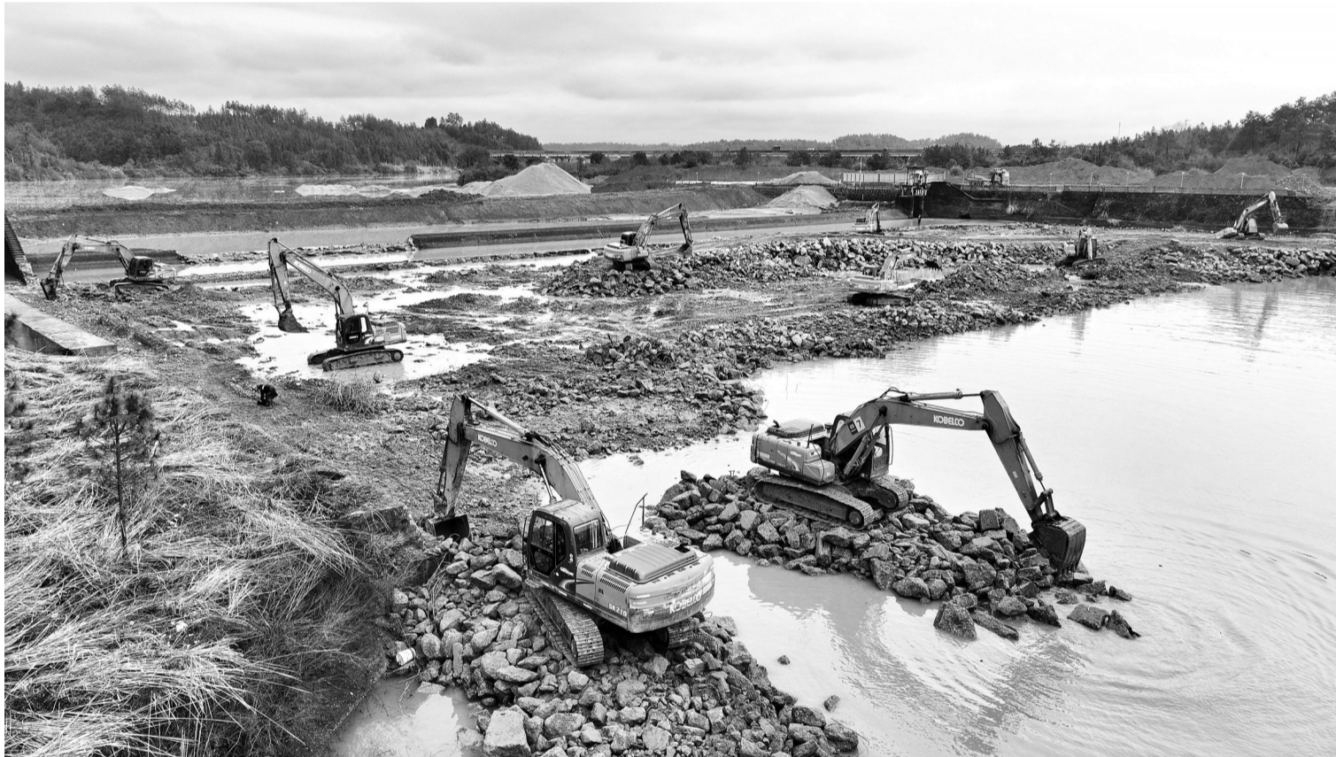
连日来,江西省永丰县恩江灌区水坝改建工地,施工队伍全力推进水闸、溢流坝、护岸等项目实施。工程竣工后,可确保坝区群众度汛安全和灌区农田灌溉用水。图为1月30日,工人在操作机械改建恩江灌区水坝。刘浩军 摄
