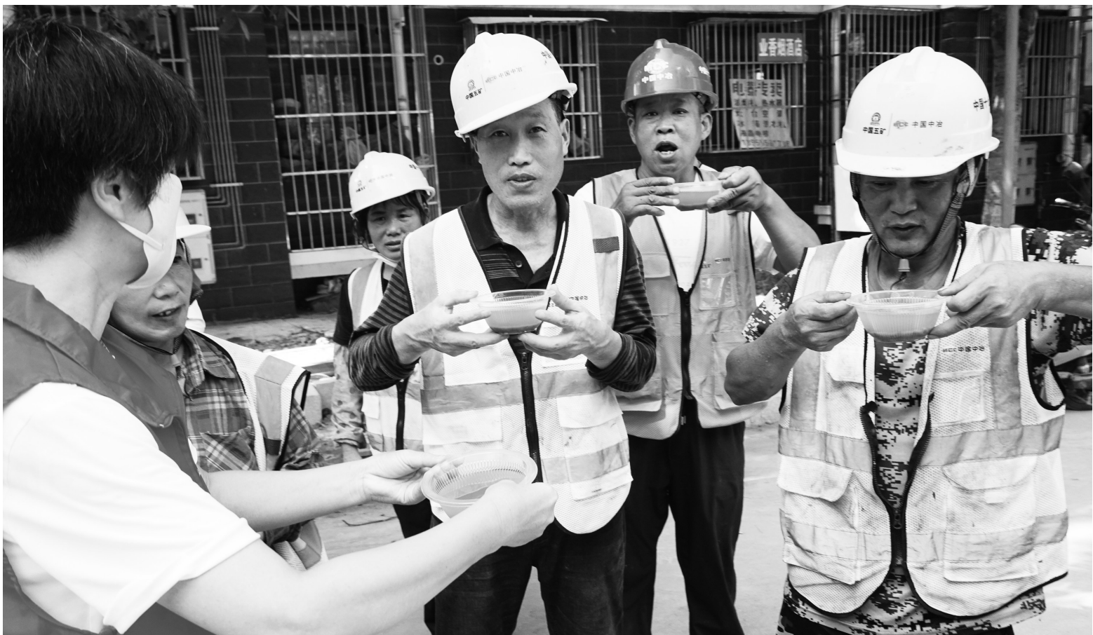
8月5日，安徽省马鞍山市花山区江东街道乔山社区党委联合工会驿站，开展“致敬高温下的一线工作者”活动，组织在职党员和楼栋长来到花山区人居环境改善提升工程(二期)桥山嘉苑项目工地，为在高温下奋战的施工作业人员送上绿豆汤、西瓜、矿泉水和防暑降温药品，并开放乔山社区工会驿站供大家避暑休息。 胡智慧 计玉婕 摄
