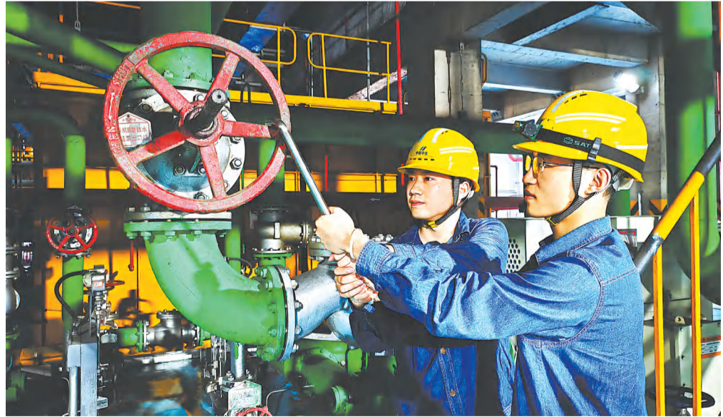
能源保供中，电厂职工查改隐患护航安全生产。
