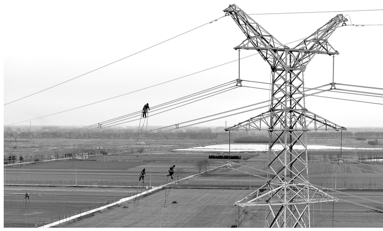
安徽省亳州市道仁新能源涡阳县风电项目一期220千伏送出工程,是国网安徽省电力有限公司投资的线路,该线路是今年亳州市第一条为输送新能源的专用电力线路,建成投运后进一步提升电网的供电能力,缓解风、光新能源的消纳问题,为地方经济发展提供电力保障。图为2月17日,电力施工人员在亳州市涡阳县境内安装220千伏输电线路相间间隔棒。 刘勤利 梁朝华摄
